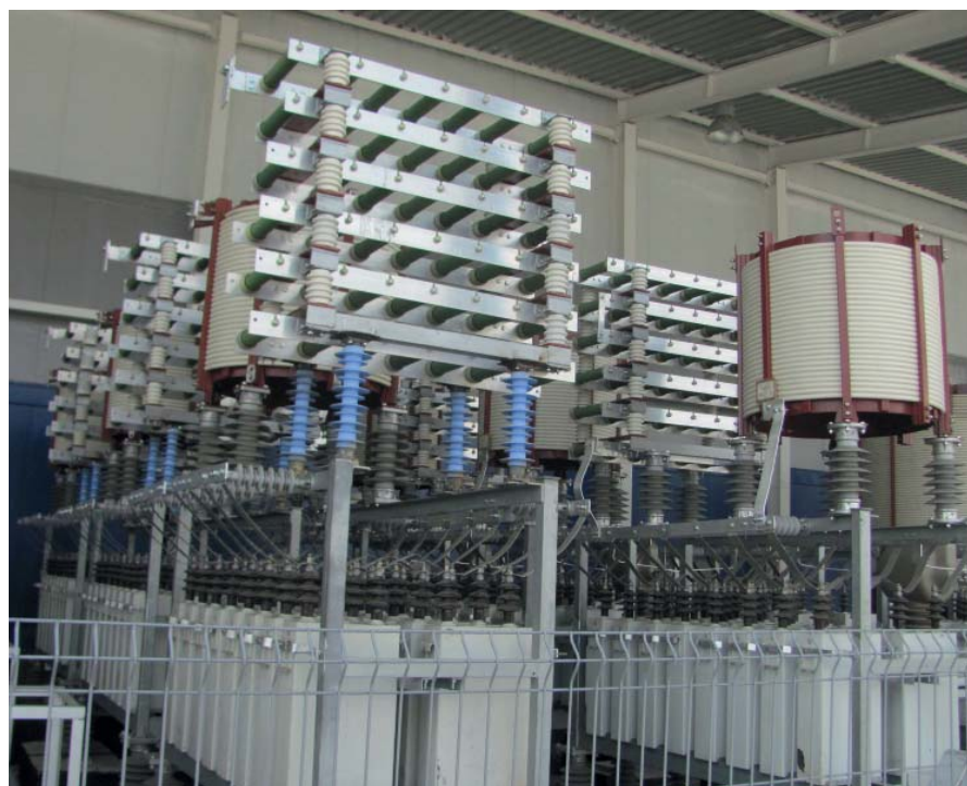
Конденсаторная батарея и реакторы фильтров
